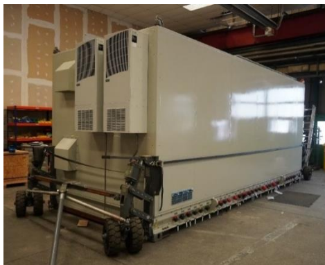
Gázturbina vezérlőház VT Rendszertechnika
